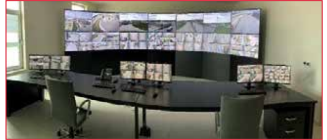
Hamzabeyli Güvenlik Kamera Sistemi Kontrol Merkezi
