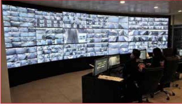
Kapıkule Güvenlik Kamera Sistemleri Kontrol Merkezi
